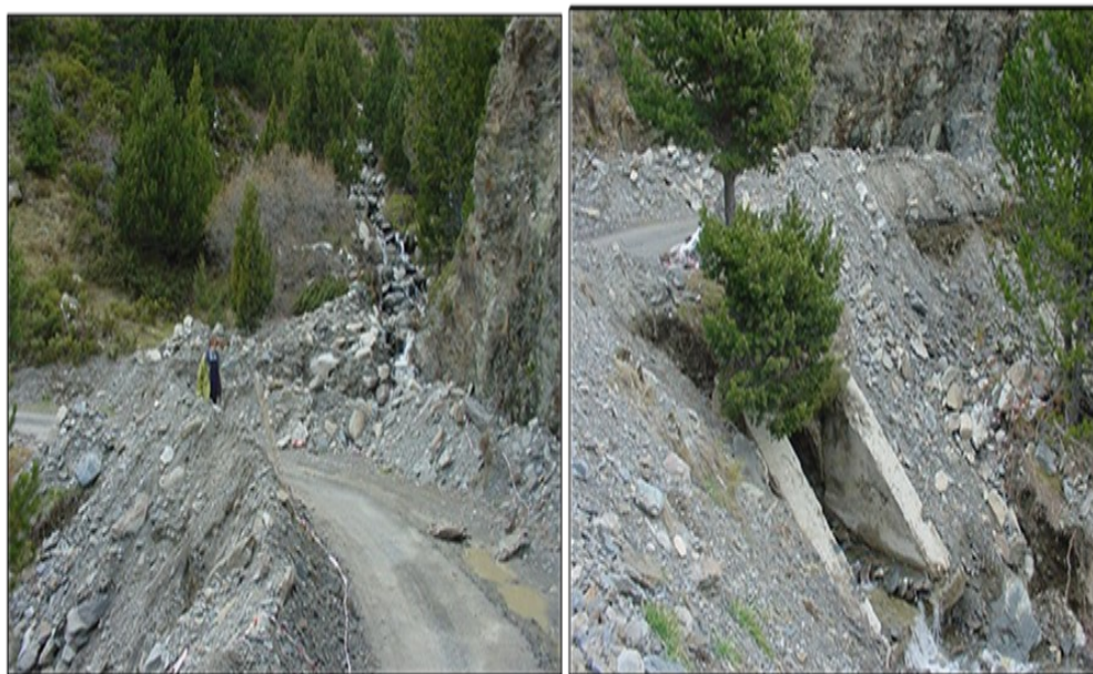
Figura 3. Fotos de la pista de acceso al monte con el tráfico restablecido, después de su obstrucción por los acarreos y bloques movilizados en el torrente.
