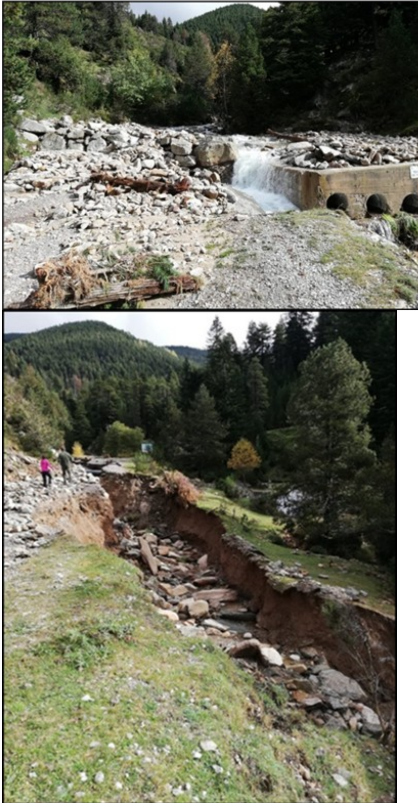
Figura 18. Fotos de la pista de acceso al monte donde el flujo torrencial erosionó el lateral derecho de la obra de fábrica y el agua que circuló por la pista la erosionó generando una cicatriz de más de ocho metros de longitud y tres metros de profundidad.
